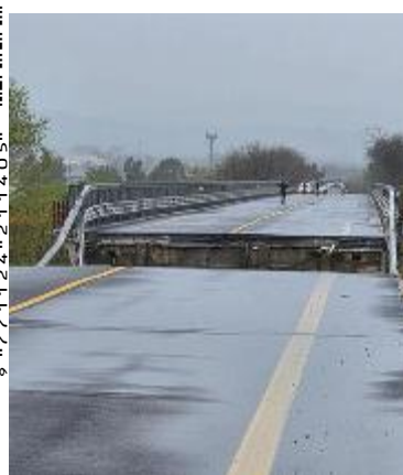
Il crollo del ponte sul Trigno
